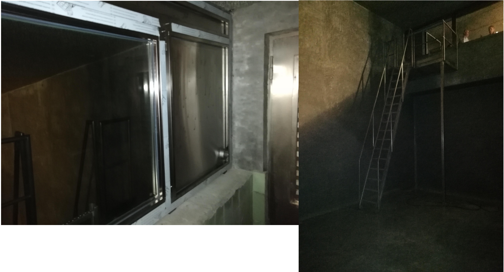
Wasserkammer Hochbehälter Eschau
